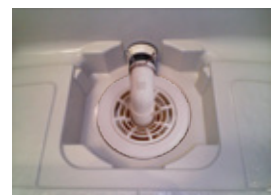
排水パイプが貫通
