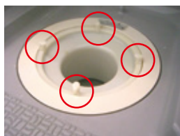
排水口上面に 突起箇所有り
